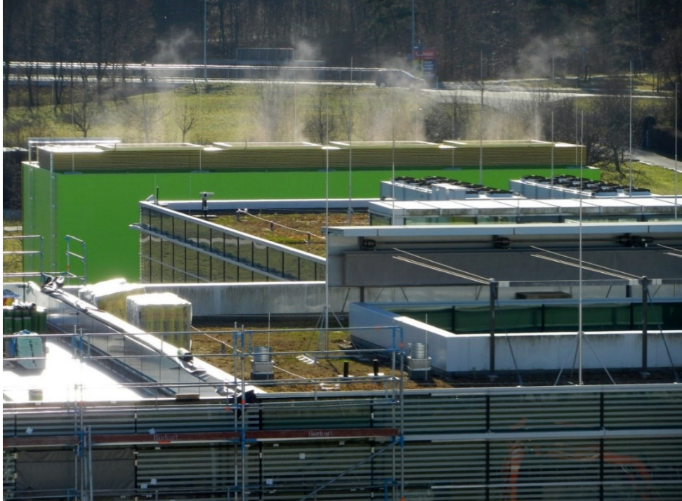
Trockenkühler (Mitte rechts) und Verdunstungskühlanlagen mit Schwaden des zur Kühlung verdunsteten Wassers (hinten im Bild) (Bild: HLRS)
